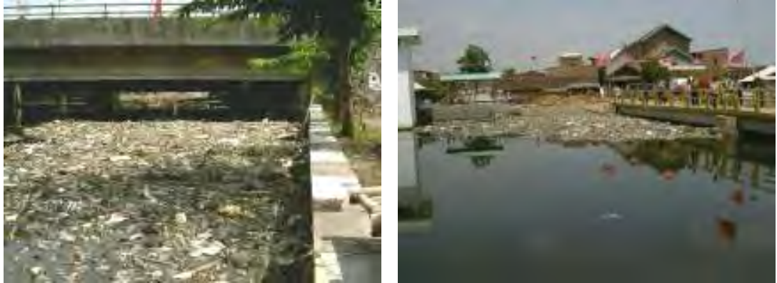
Gambar 3-3 Timbunan sampah yang terjebak di jembatan-jembatan menyebabkan kapasitas saluran menurun
