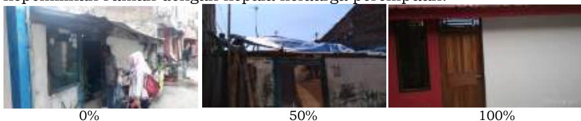
Gambar 3. 1 Kegiatan Rehabilitasi Rumah Tidak Layak Huni atas nama Miyem, Kelurahan Mugassari Kecamatan Semarang Selatan
